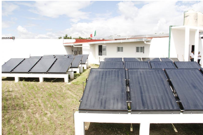
Imagen 4. Paneles solares de la empresa
