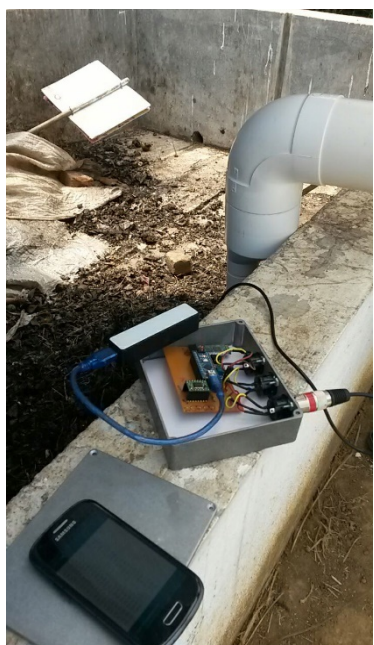
Ventilador 4. Sensor de Temperatura
