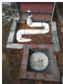
Figura 11. Sistema de filtrado
