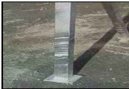
Figura 11. Líneas de oxido (CEMESA Galvanizadora, 2015)
