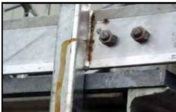
Figura 13. Sangrado de oxido (CEMESA Galvanizadora, 2015).
